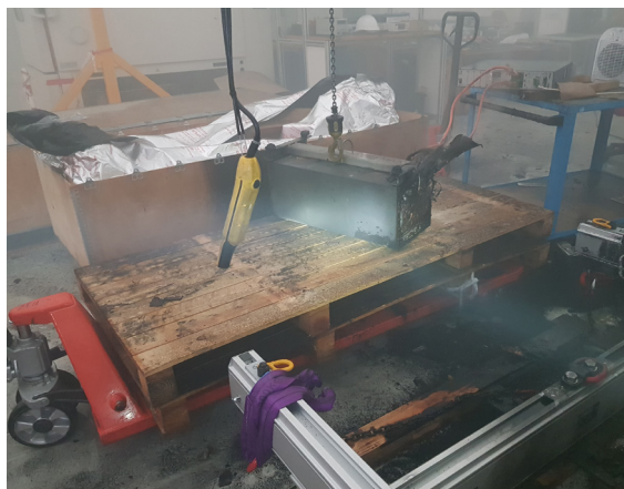
Batterie de 7 kWh à l'origine du sinistre
